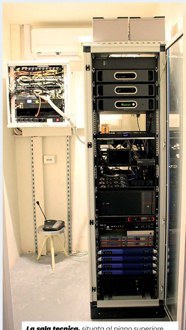
La sala tecnica, situata al piano superiore, dove convogliano tutti i segnali
